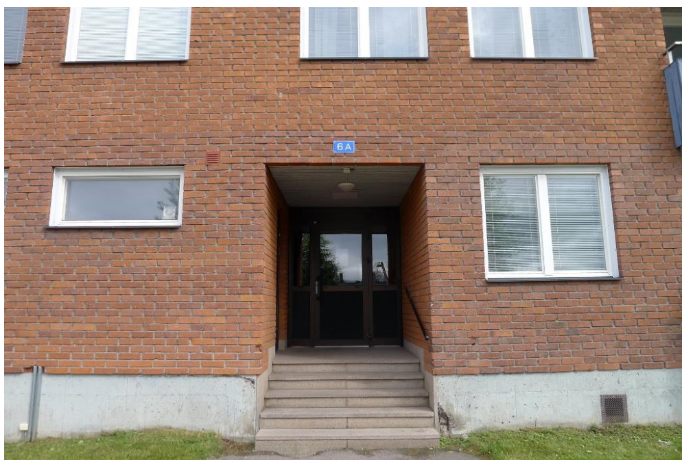
Entré till Bromsgatan 6A. Dörrpartiet är utbytt till ett i isolerglas och brunlackerad aluminium, de var ursprungligen i träfanér.
