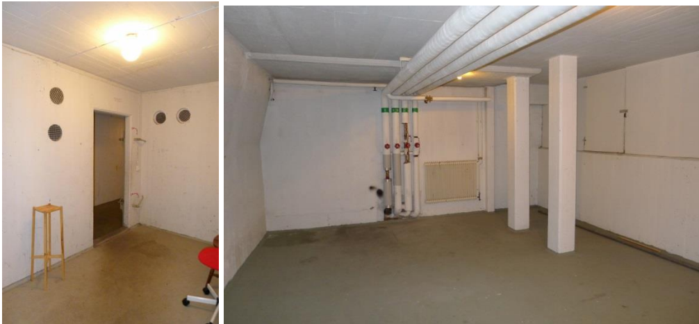
I skyddsrummen är betongväggar och tak vitmålade. Golv är målade i grågrön kulör.
