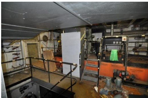
Interiör från panncentralen, den orangefärgade delen mitt i bilden är torvpannan som installerades i mitten på 1980-talet.
