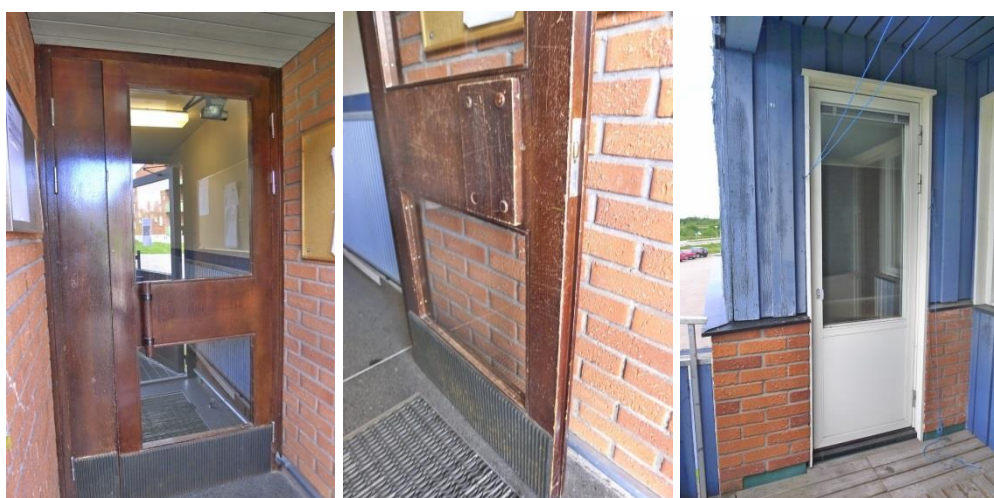
Ursprungligt ytterdörrsparti i fanerat trä (C2). Dörrblad med två glasrutor och sparkplåt, gummerad beläggning. Till höger balkongdörr till ett tvåvåninghus. (D3)
