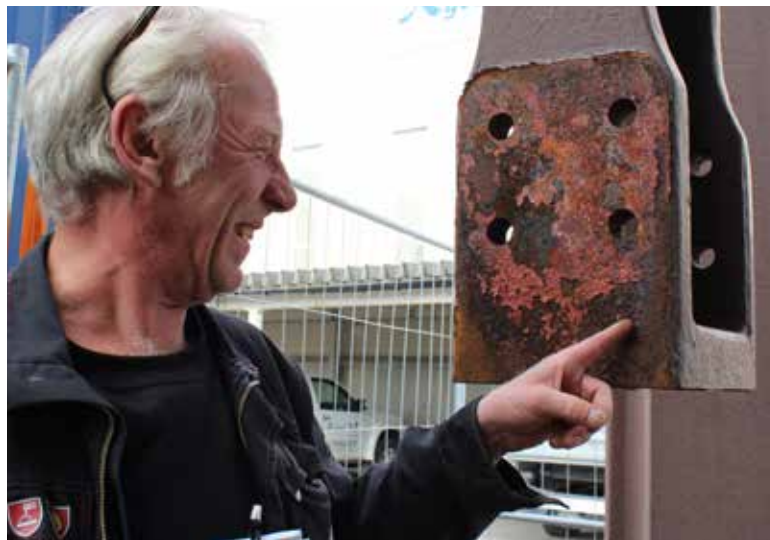
Leif Larsson, som håller i demontage- och montageprojektet av klocktornet, visar rostangreppen på tornet.
