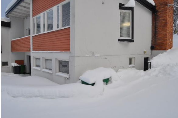
Kraftig sprickbildning i den murade ytterväggen.
