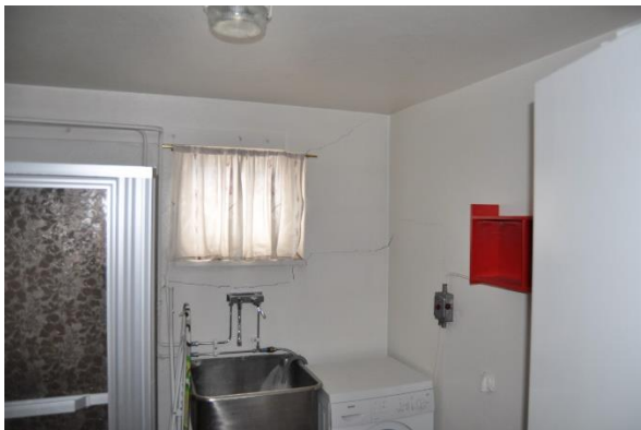
Sprickorna är genomgående
