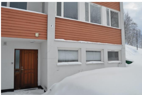
Sprickorna förekommer på många väggar
