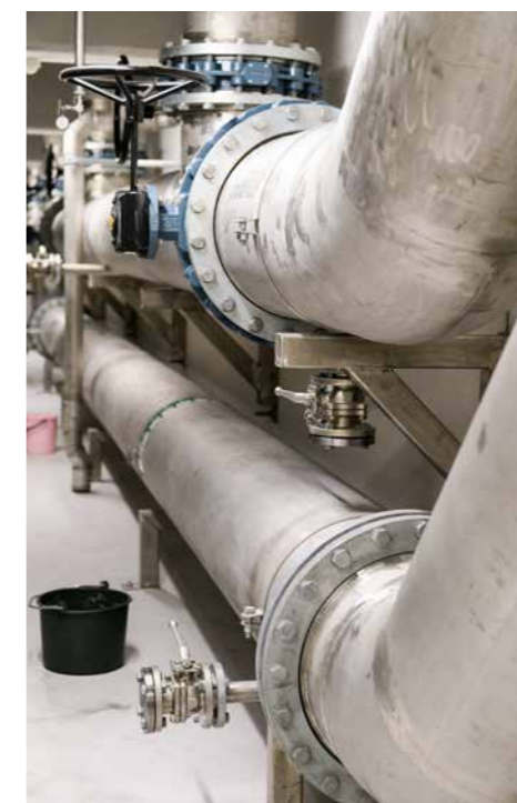
En mängd rör i kraftiga dimensioner för vattnet genom vattenverket och de olika reningsstegen.
