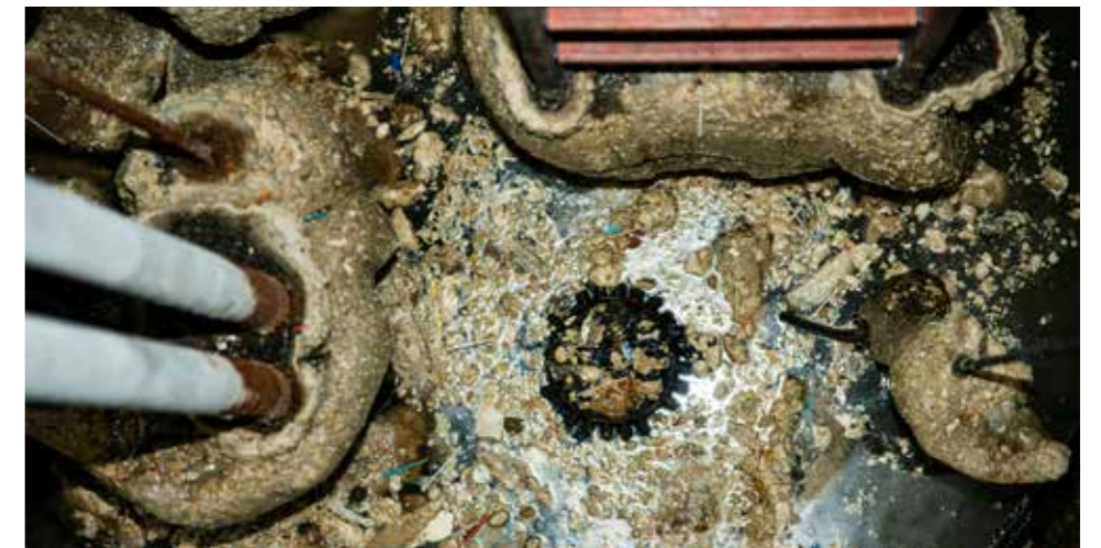
Stora fettklumpar flyter omkring och täpper till våra avloppsledningar.
